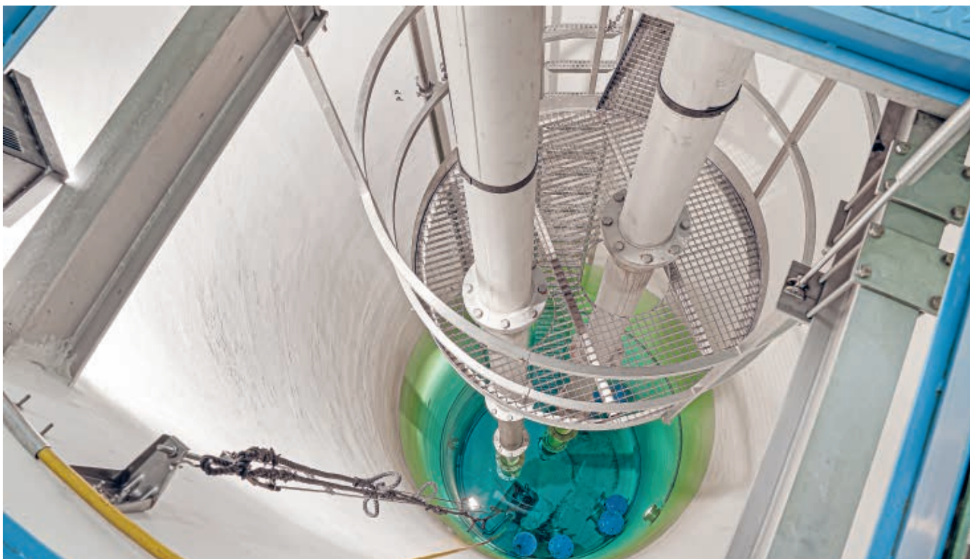
Pumpwerk Au Nord: Grundwasserbrunnen 1
