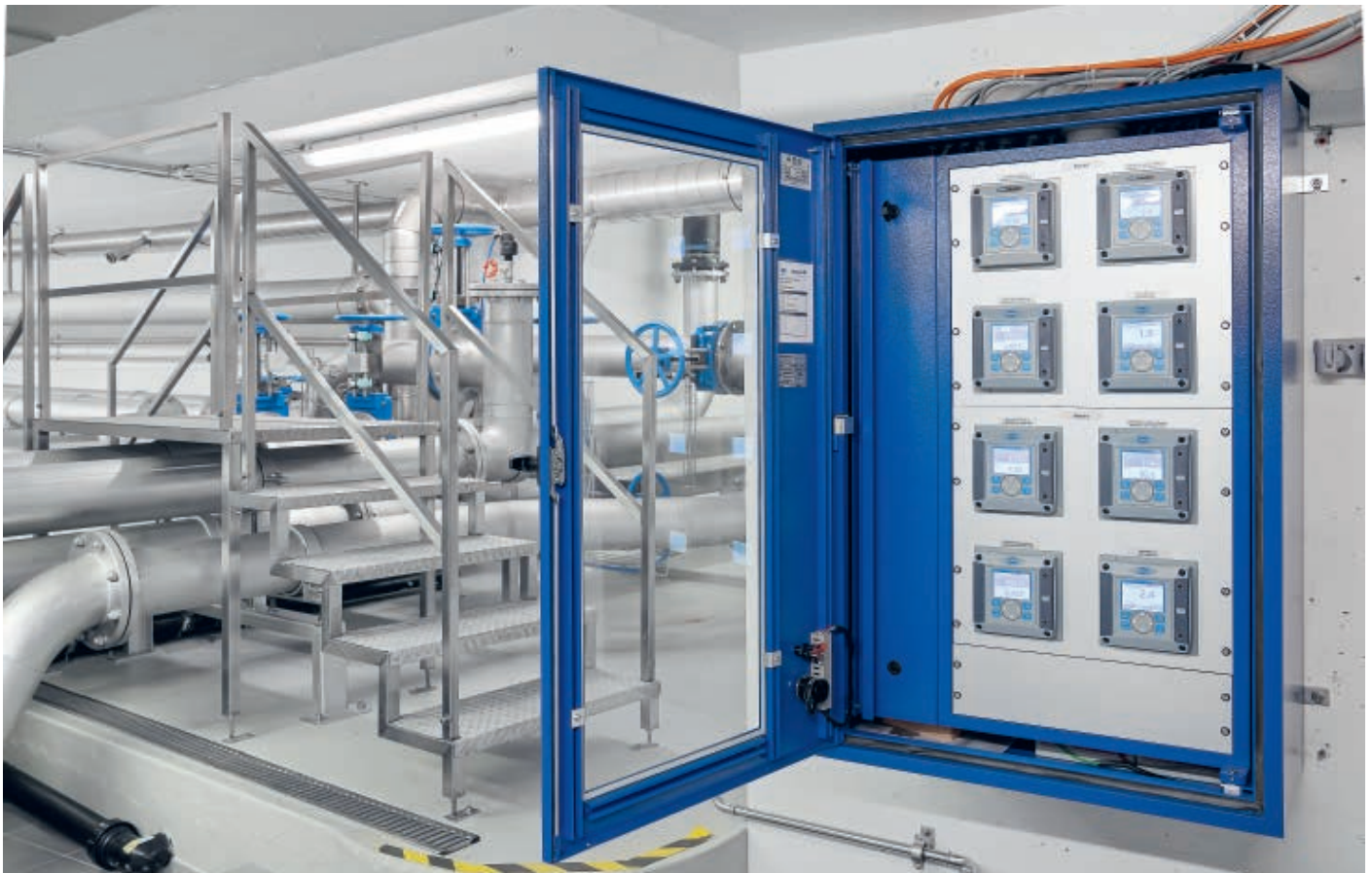
Pumpwerk Au Nord: Leitungsstollen mit Schaltschrank
