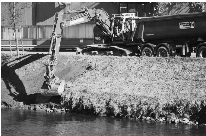
Sedimentabtrag am Binnenkanal (Industrie Böschach)
