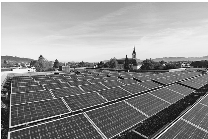
Photovoltaikanlage Schulhaus Wyden
