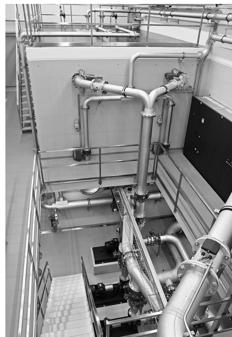
Neue Filteranlage im Wasserwerk ABRW
