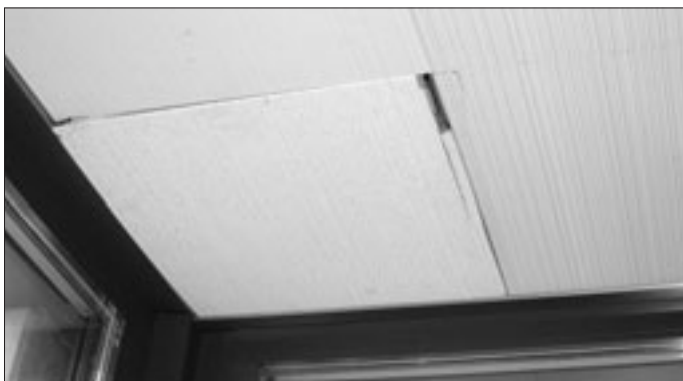
Gemeindehaus: Deckenplatten lösen sich ab
