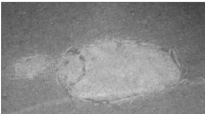
Abgelaufener Nadelfilz-Boden im 1. Stock
