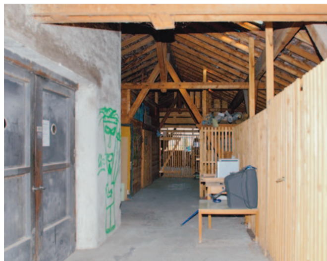
Ist-Zustand: Der Estrich
