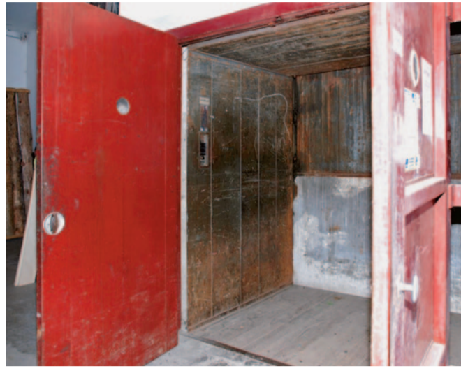
Ist-Zustand: Der prekäre Warenlift
