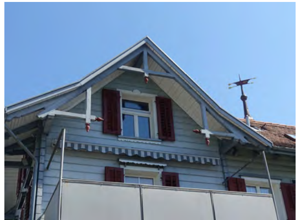
Gestaltung des Quergiebels mit störendem Terrassengeländer
