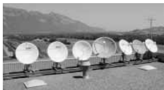
Empfangsanlagen Kopfstation EWB, Buchs
