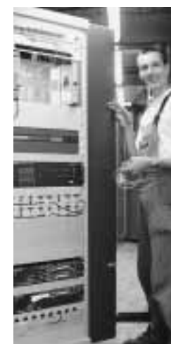
Module für die Signalaufbereitung und Verteilung
