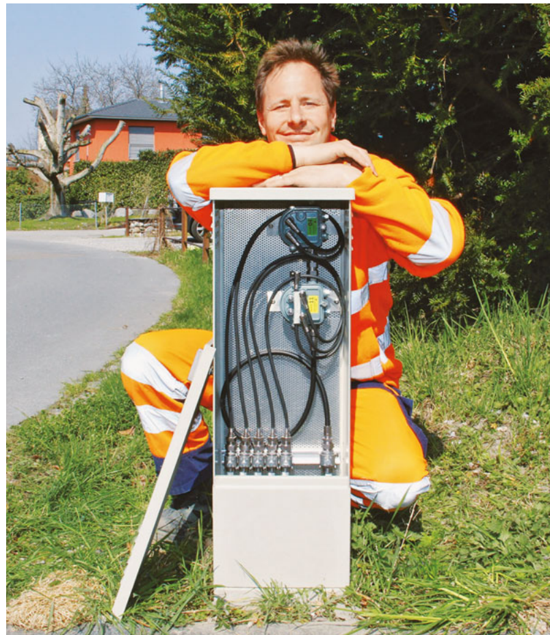
Jürg Meier, Kabelnetz Widnau
