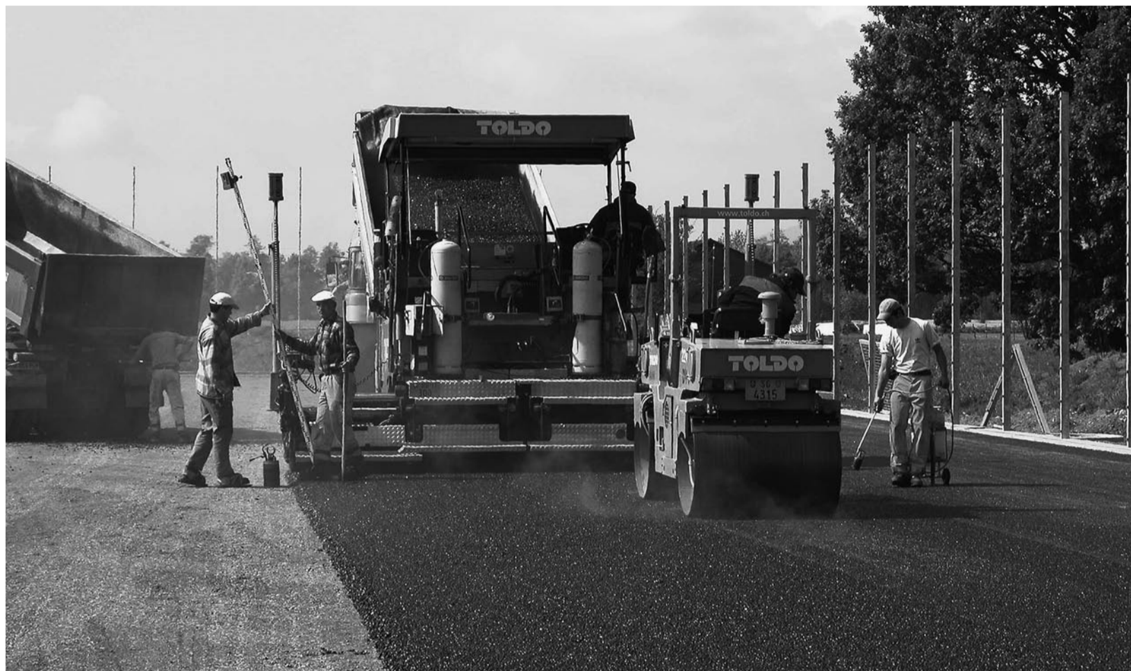
Mitte Mai war es so weit: In Laser unterstützter, millimetergenauer Arbeit wurde die Sickerasphaltschicht eingebaut.
