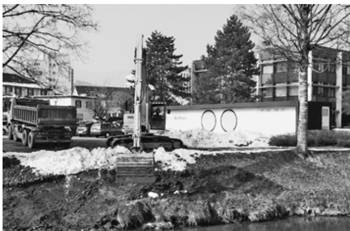
Sedimentabtrag beim RBK – Höhe Gemeindehaus
